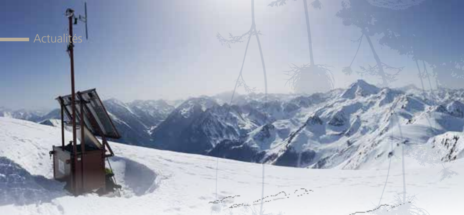
Station radio au pic du Cabalros (65)
