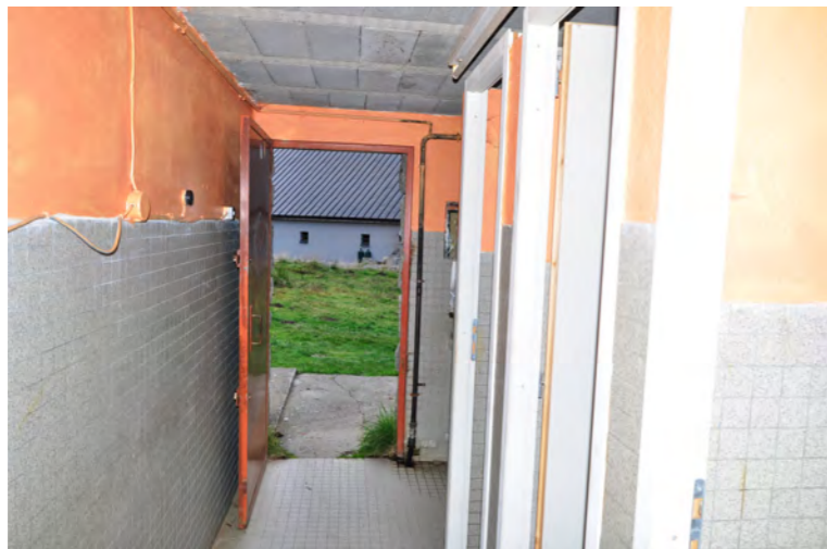
Les carrelages muraux et au sol à désamianter
