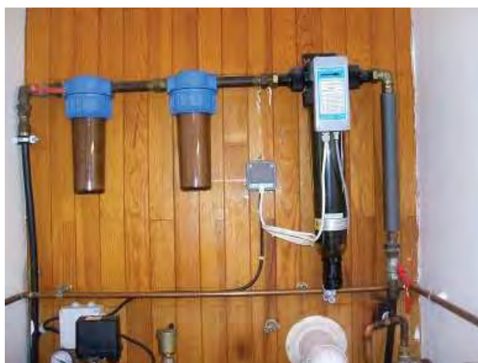
Filtres d'arrivée d'eau et traitement UV
